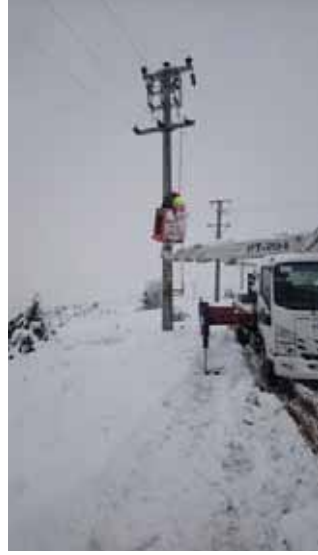
Şekil 269. Uydu Kent Bölgesi Elektrik Arızası Çalışması
