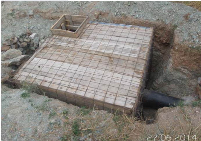
Geven Mahallesi-Eski kamyon garajı arası sıcak su isale hattı
