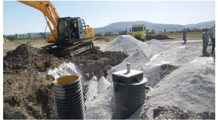
Perli Mahallesi Atık Su Terfi Merkezi
