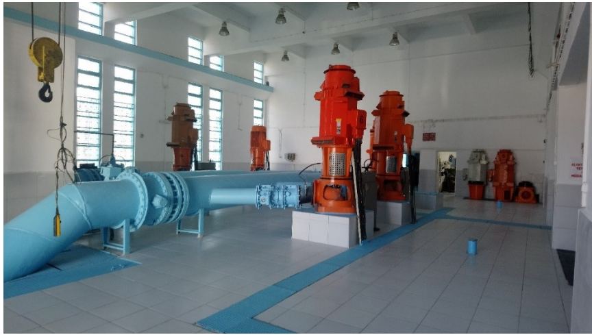
Resim 183. Porsuk İçme suyu Tesisinde Çalışan Pompaların Görüntüsü
