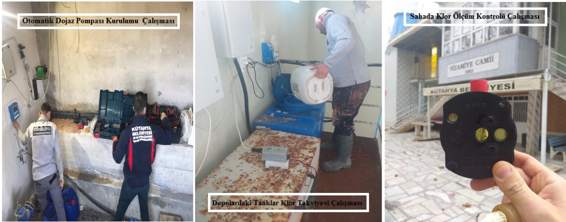
Resim 182. Klor Servisi Çalışmaları
