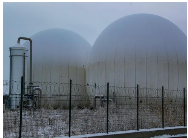
Resim 186. Gaz Depolama Ünitesi
